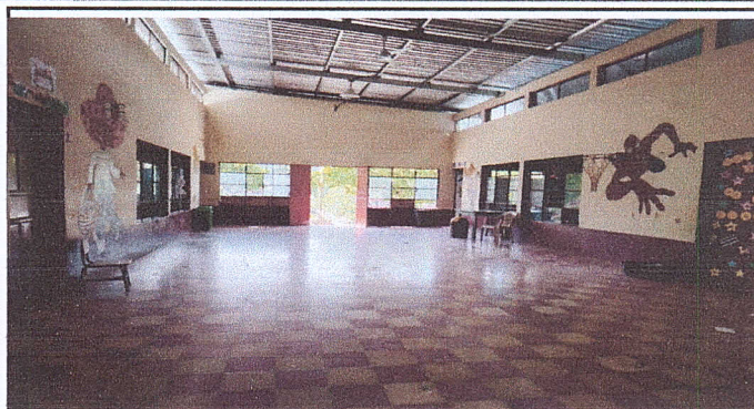
Pintura en muro interior
